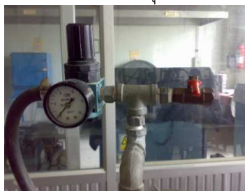
รูป การตั้งแรงดันลม
